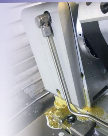
Fuerte pérdida de aceite
