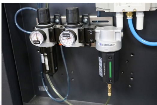
An der Rückseite der Doosan-Maschine DNM 4500 sind neben der gesamten Wartungseinheit auch die pL LEHMANN-Komponenten Druckminderer und Lufttöler gut zugänglich angebracht.
